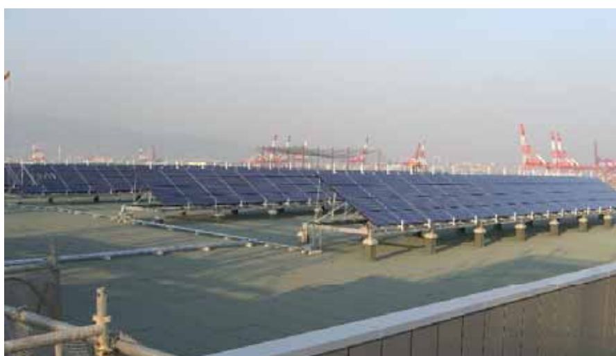
太陽光発電パネル (屋上)
