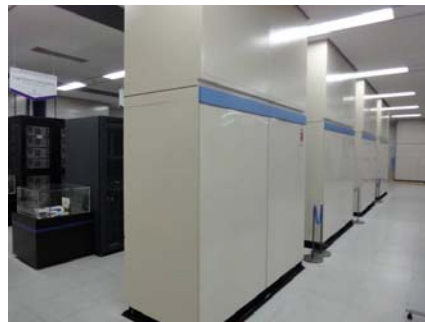
増設した空調機
